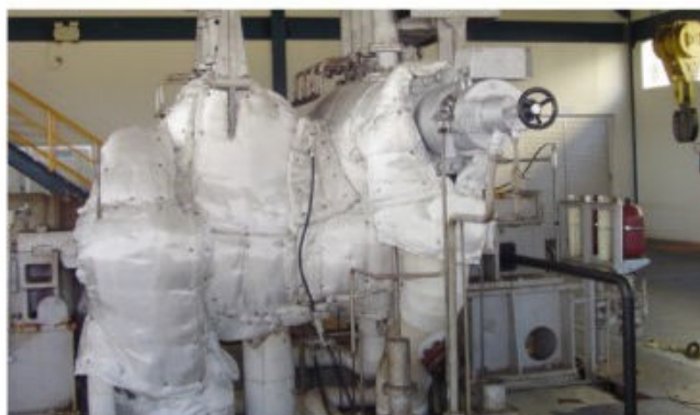
Turbina de Geração de Energia
